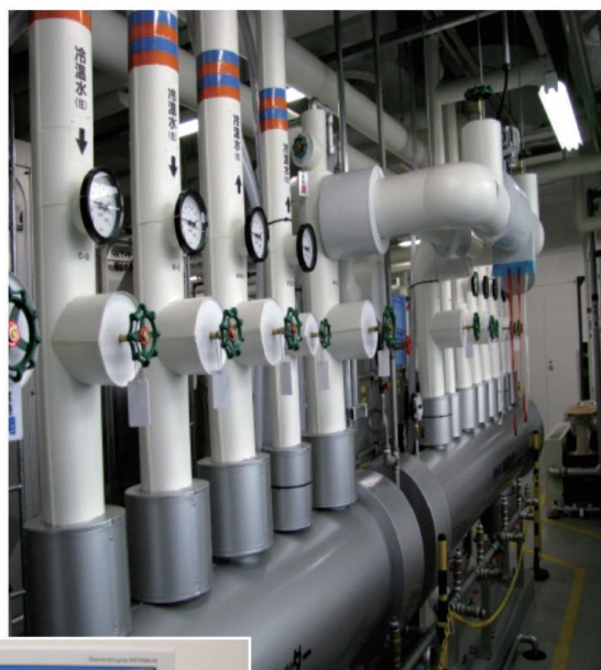
冷温水ヘッダー
