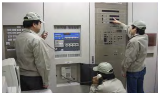
実習の様子(防災センター業務)
