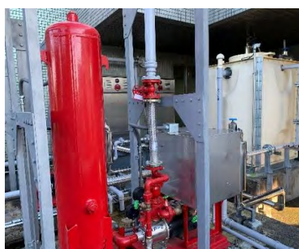
消火栓・スプリンクラー実習設備
