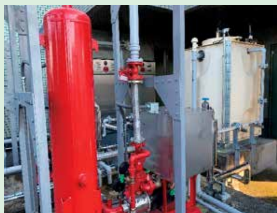
消火栓・スプリンクラー実習設備
