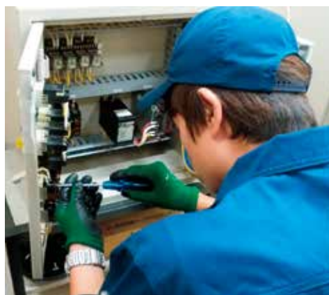
制御盤配線実習
