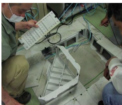
床配線の確認
