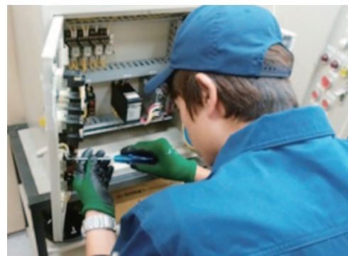
制御盤配線実習
