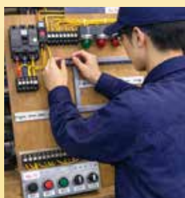
電気制御配線 ※
