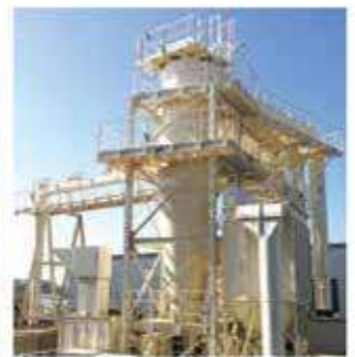
工場内の廃棄物処理設備
